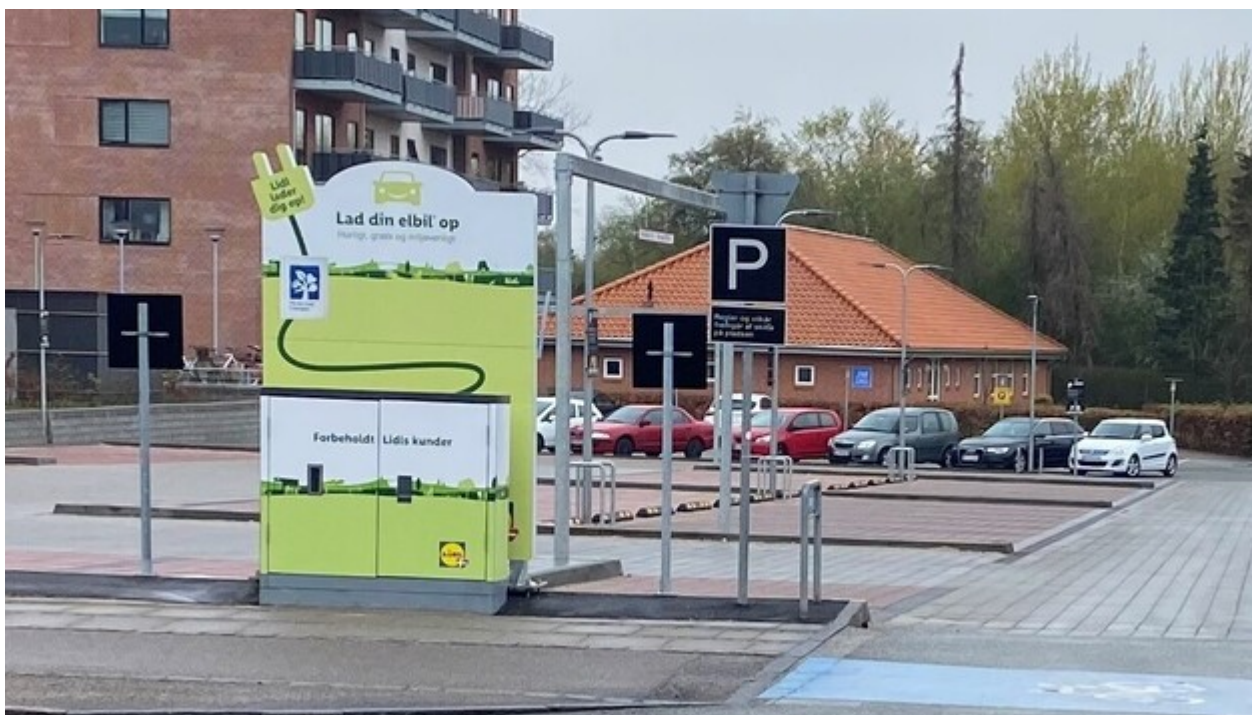
El-ladestander på parkeringsplads. Foto: Frederikssund Kommune.
