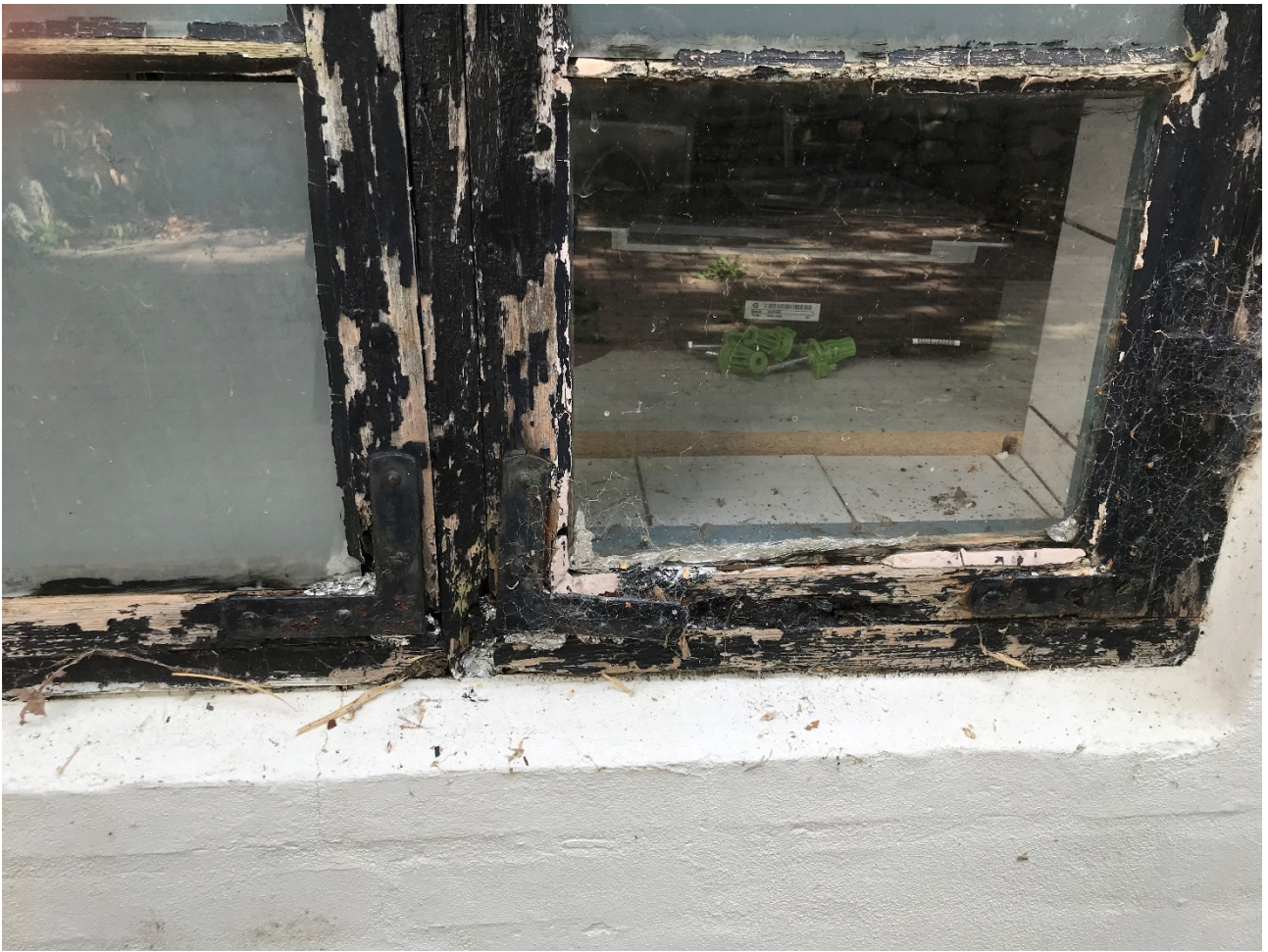
Træværk ved vinduer er stræk medtaget, især ved de ældste vinduer.
