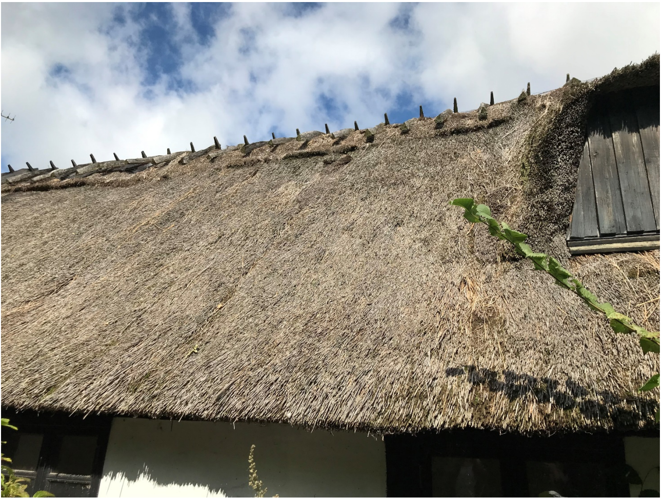
Synlige huller i tag og strålaget er meget tyndt
