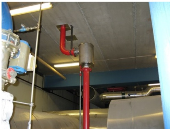
Udsugning med filter fra krumtaphus på værket.
