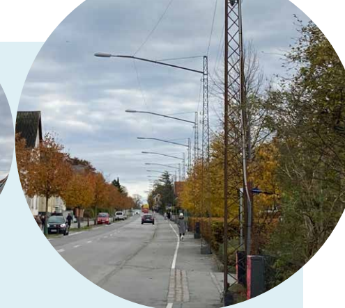
Gittermaster med luftledninger på Roskildevej i Frederikssund
