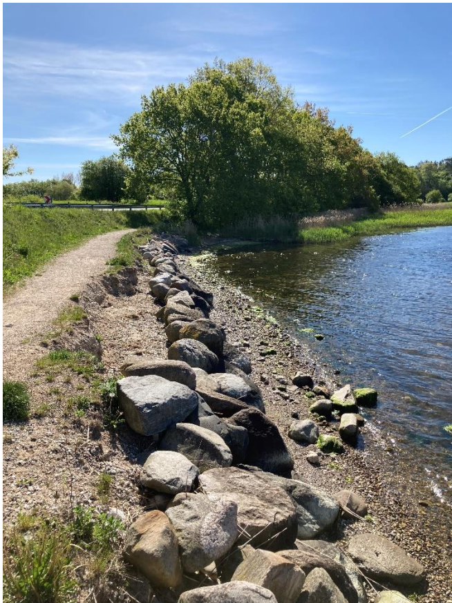
Figur 2: Stien, hvor den eksisterende skråningsbeskyttelse er styrtet sammen.
