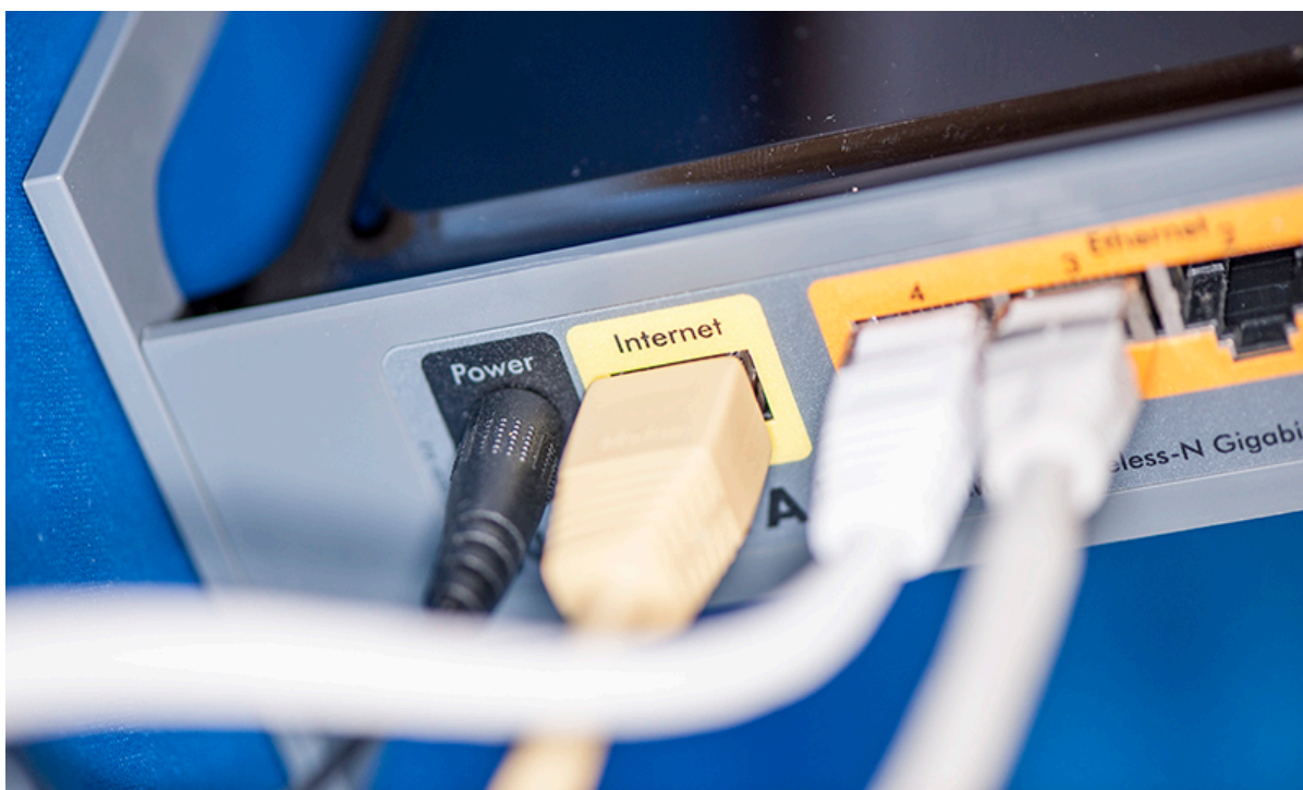
Internet router med netkabler. Foto: Kenneth Jensen, Frederikssund Kommune.
