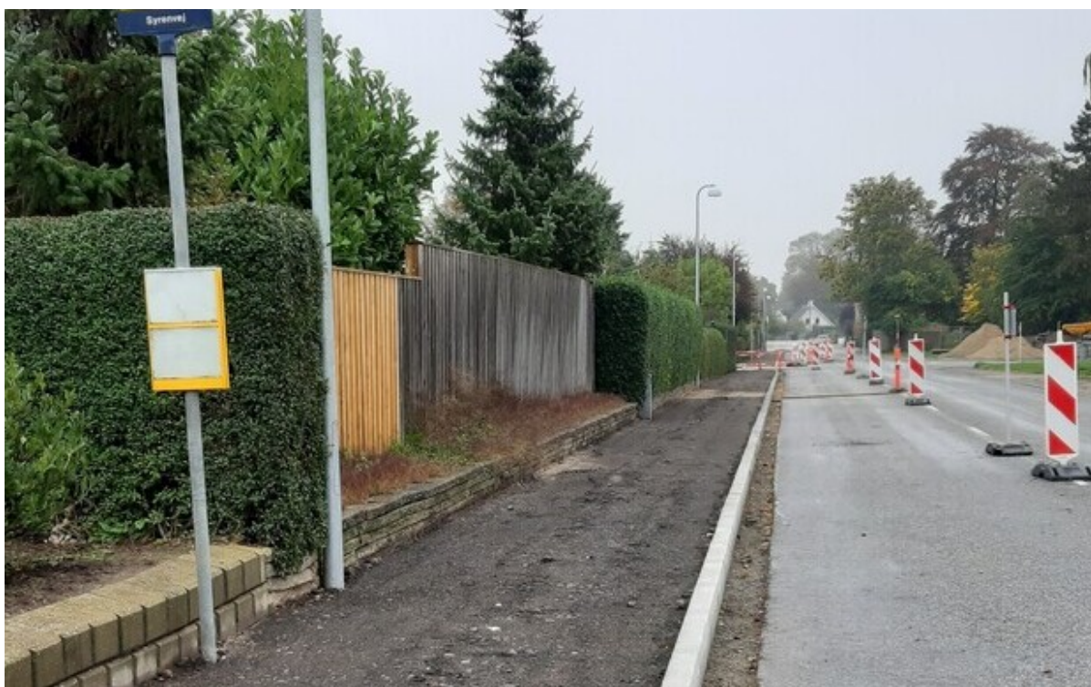
En del af strækningen på Saltsøvej i Skibby, hvor der arbejdes med anlæggelse af ny fællessti. Foto: Frederikssund Kommune.
