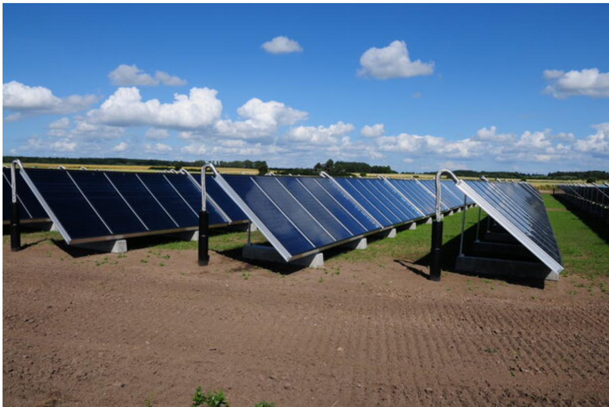
Solvarmeanlæg ved Jægerspris. Foto: Kenneth Jensen, Frederikssund Kommune.
