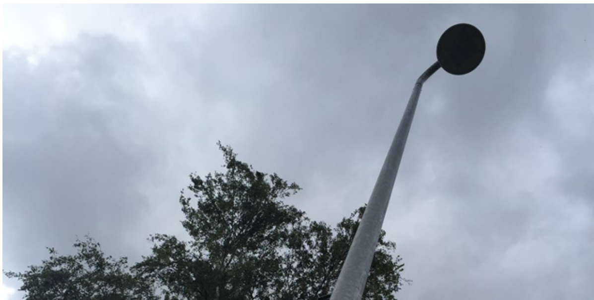
Slukket gadelampe. Foto: Frederikssund Kommune.
